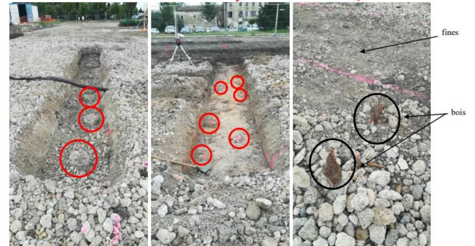
Tête des inclusions découvertes au droit des feuilles des fondations Toutes les inclusions n'étaient pas encore visibles et certaines semblaient décalées → A vérifier
